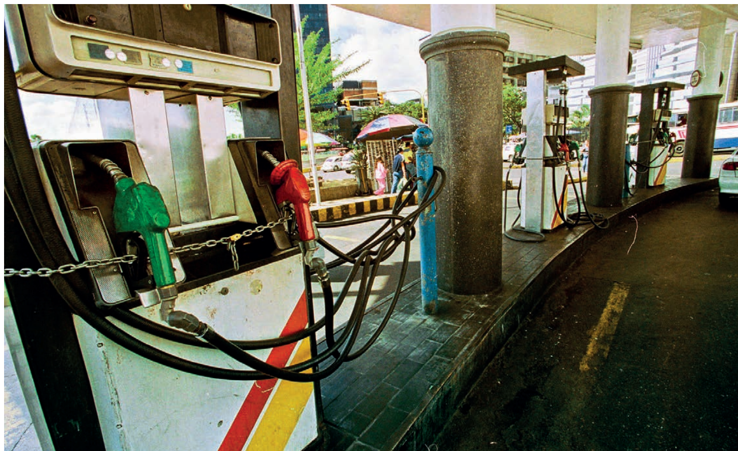
Sistema de distribución de combustible clausurado durante el sabotaje petrolero FOTO ERNESTO MORGADO
